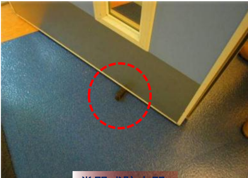
常閉式防火門
