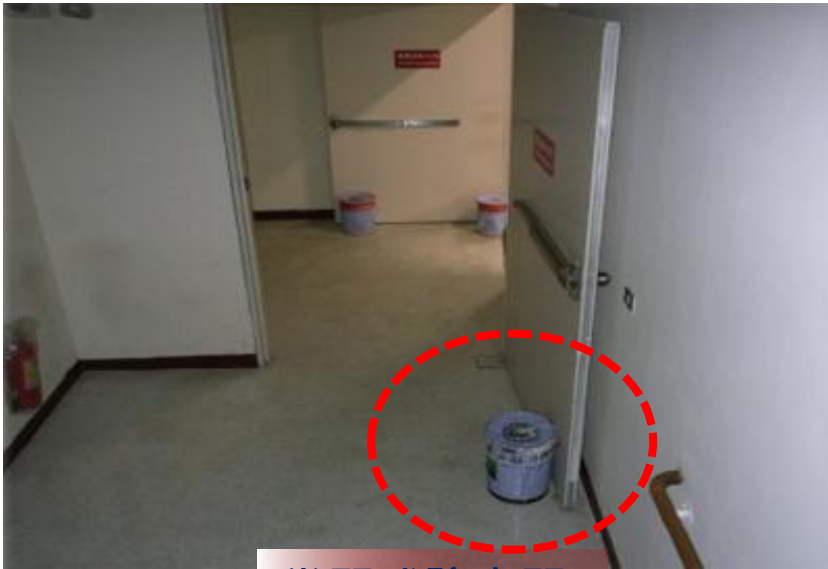
常閉式防火門
